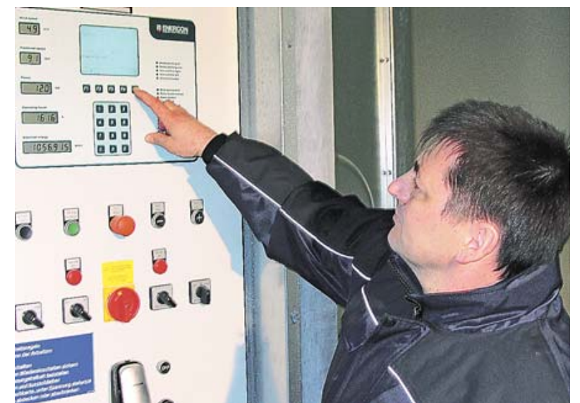
Da fließt der Strom: Juwi-Techniker Thomas Kirsch an der Trafo-Anlage eines Windrads. 120 Kilowatt werden in diesem Moment produziert.
