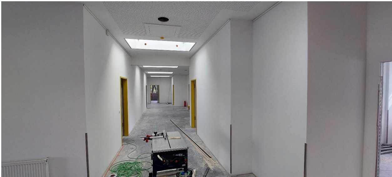
Abb. 24: Kita Friesenstraße, Flur EG Quelle: Gebäudemanagement: Aarne Bäuerle, Stefan Erhardt
