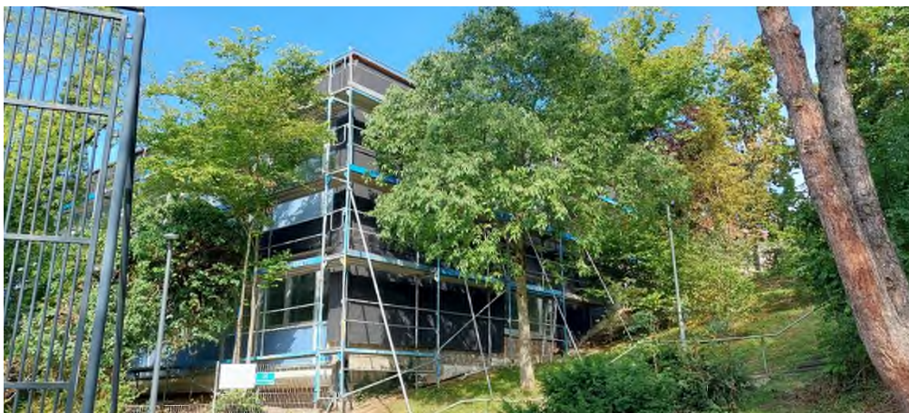
Abb. 21: Kita Friesenstraße, Ansicht Süd Ost Bestand Fassade Quelle: Gebäudemanagement: Arne Bäuerle, Stefan Erhardt
