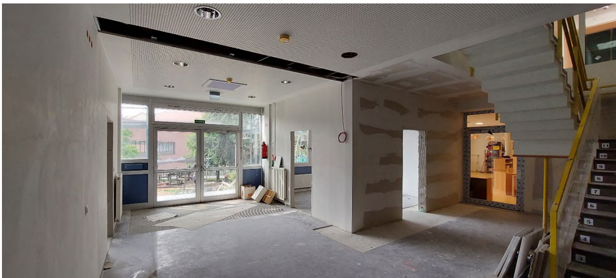
Abb. 25: Kita Friesenstraße, Ausgang UG Zugang zum Neubau Quelle: Gebäudemanagement: Aarne Bäuerle, Stefan Erhardt
