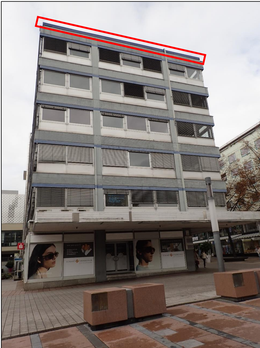
Abbildung 4: Die Attika im Dachbereich ist für gebäudebewohnende Fledermausarten aufgrund der glatten Außenfassade ebenfalls als Quartier ungeeignet (rote Markierung).
