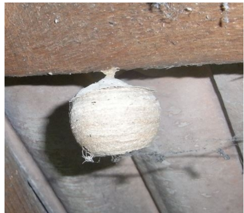
Abb. 29: Wespennest im Dachstuhl des leerstehenden Wohnhauses Nr. 26.
