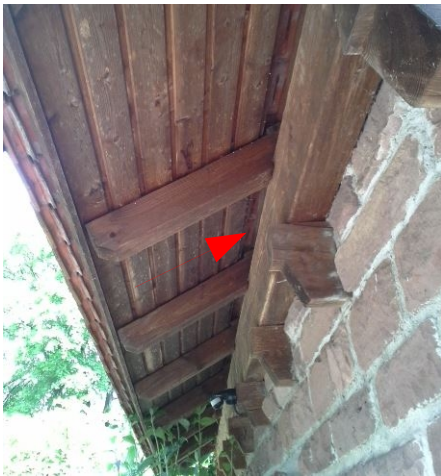
Abb. 20: Einflugmöglichkeit in den Dachstuhl einer Garage (Pfeil)
