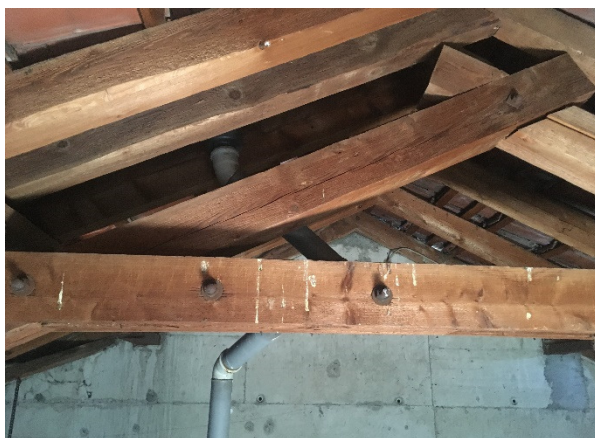
Dachstuhl des Westflügels mit Kotspuren
