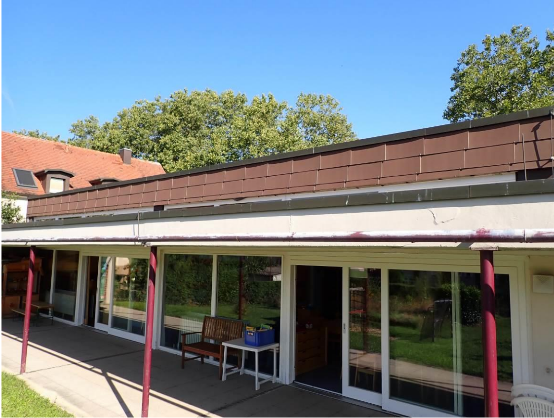
Abb. 19: Attika und Eternitverkleidung am Kindergarten.
