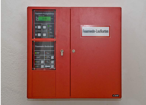
Feuerwehrbedienfeld im Treppenhaus Süd
