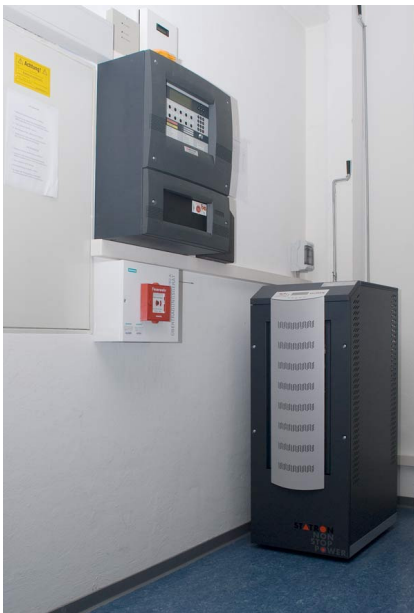
Brandmeldezentrale im Erdgeschossmagazin
