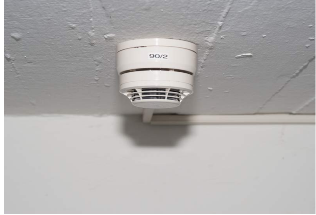
Deckenrauchmelder im Magazin
