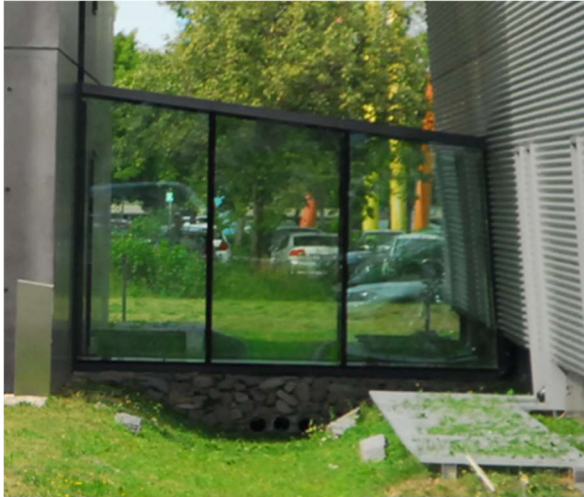
Abb. 11: Transparenter, beidseitig verglaster ebenerdiger Übergang zwischen zwei Gebäudeflügeln; Vogelverluste sind hier nachgewiesen (B.-U. Rudolph).
